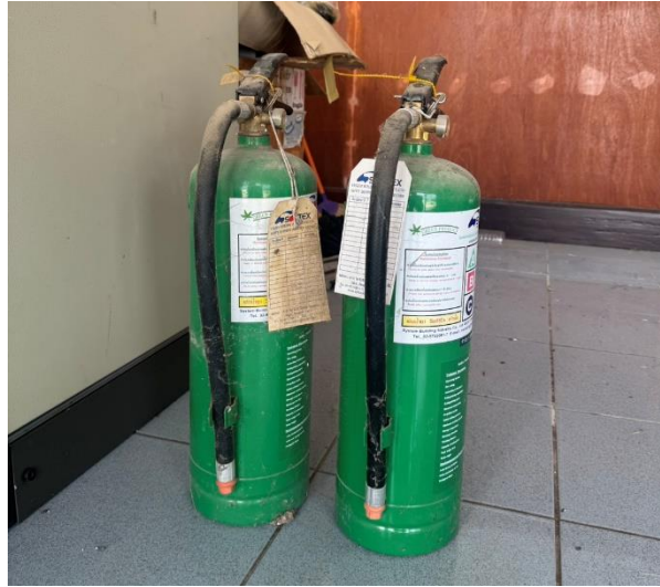
ถังดับเพลิง
